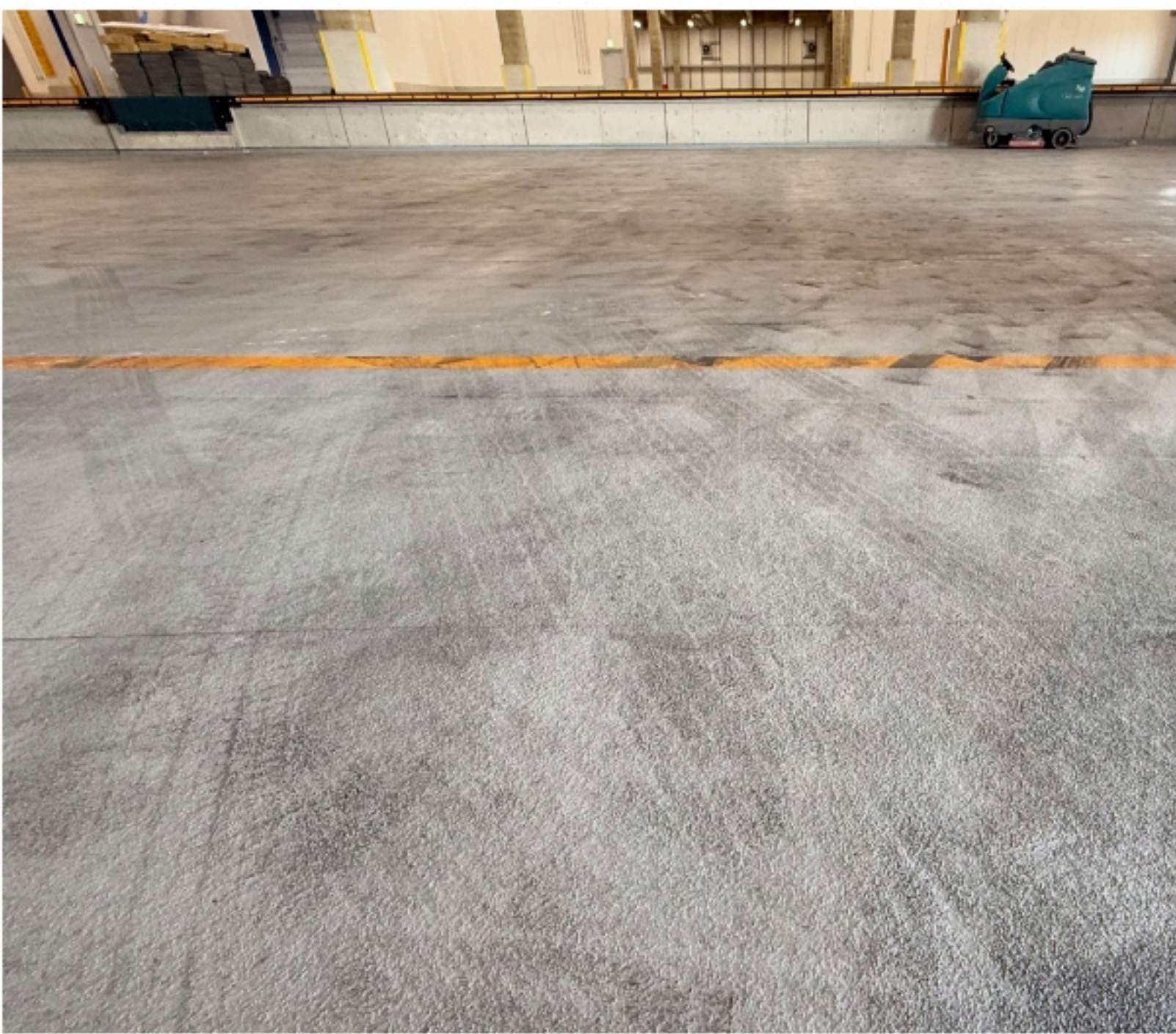
①タイヤ痕で汚れたトラックバース
